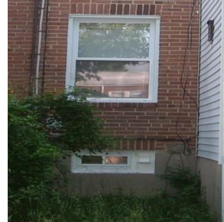
EFFICIENT WINDOWS (HUD)
